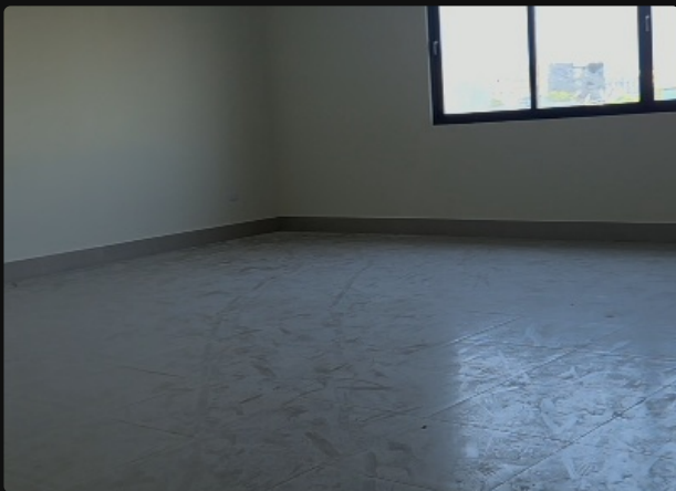
Superficies con polvo de construcción y residuos.
